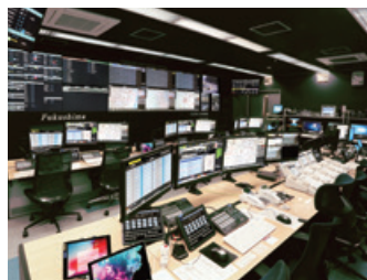
住民のみなさまの安心・安全を支える 消防・救急通信指令システム
